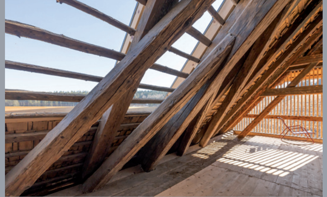
Gleicher Hof wie S. 18 mit der Lichtwirkung von Innen. Trotz modernem Ausbau ist die historische Holzkonstruktion samt Schindeldeckung erhalten (siehe auch Titelbild)
